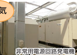
非常用電源回路発電機
