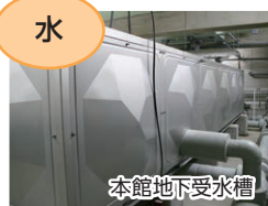
本館地下受水槽
